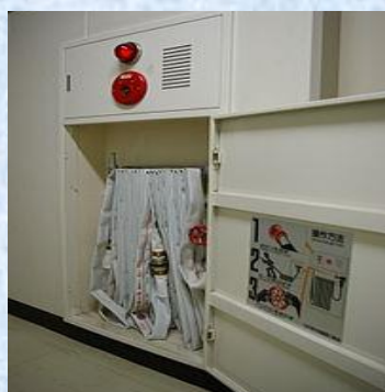
(屋内消火栓設備)
